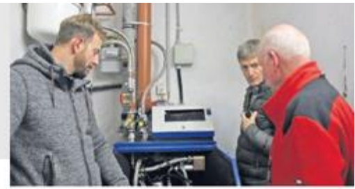
Die Energiebeauftragten der teilnehmenden Sportvereine haben sich in Schwachhausen unter anderem das Blockheizkraftwerk von Bremen 1860 angesehen.
