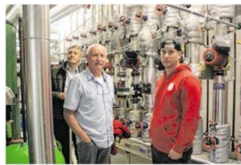
Bernd Langer von der Gesellschaft Beks-Energieeffizienz (v.l.), Toni Schiller und Steven Holtwedel vom Tus Komet Arsten im Heizraum. FOTO: FR
